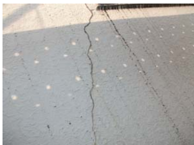
開口まわりのクラック
