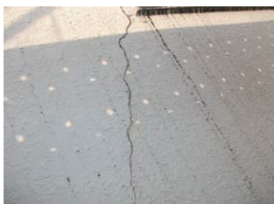
開口まわりのクラック
