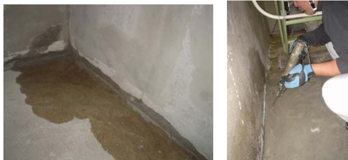
切付からの漏水に効果的です
